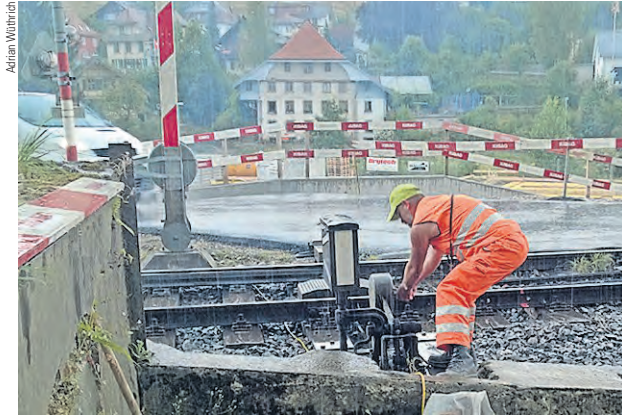
Etwa die BLS investiert jährlich 20 Mio. in ihre Sicherungsanlagen und will bis 2022 alle alten Stellwerke ersetzen – wie diesen Sommer in Huttwil, wo die Handweichen am 17. Juli letztmals gestellt wurden.
